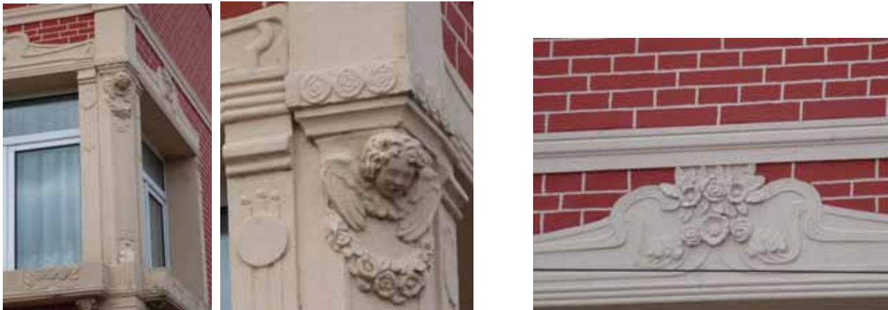
Encadrement de fenêtre particulièrement travaillé. Le style est Art déco avec des roses stylisées. L'angelot apporte une touche d'éclectisme. Le reste de la façade est réalisée en enduit imitant la brique.
