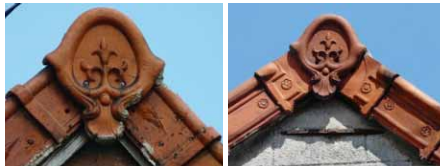
Deux ornements de terre cuite identiques, au sommet du pignon, à la jonction des deux rives de toiture.
