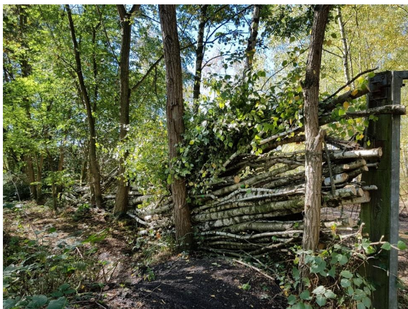
Travaux de confection d'une barrière végétalisée afin de mettre en défens des habitats
