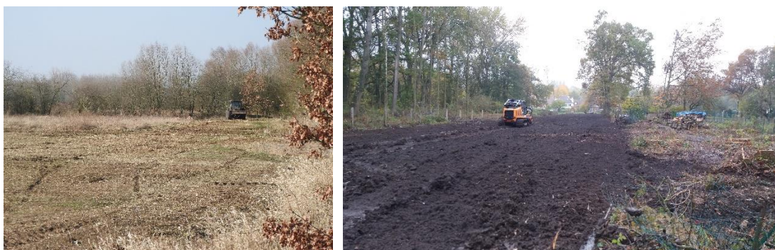
Exemples de mise en œuvre de la mesure sur les communes de Crespin et Raimbeaucourt
