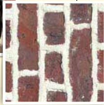
⚠ joints trop épais et trop blancs (à éviter)
