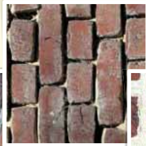
anciens joints adjuvants (à rejointoyer)
